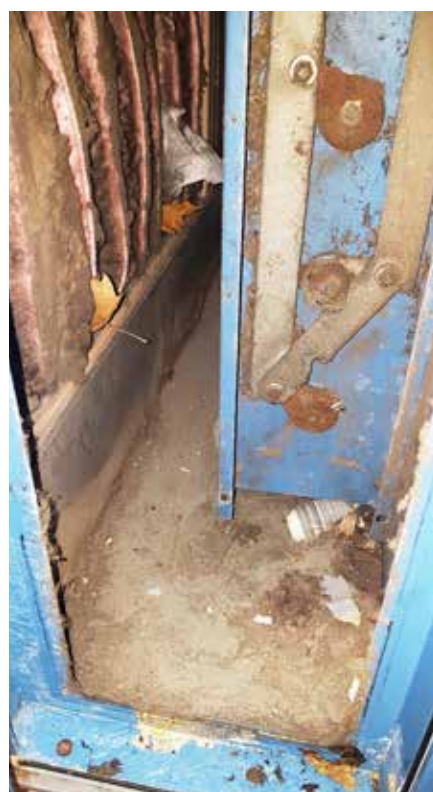
De aanzuigfiltersectie is gecorrodeerd.
